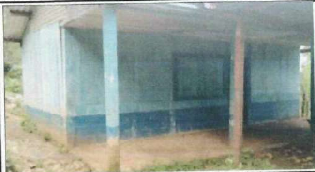
Foto 1: Se observa el estado de la cocina a remozar.
