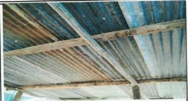
Foto 2: Se Observa la necesidad de cambio de laminas de la direccion del establecimiento y las costaneras.
