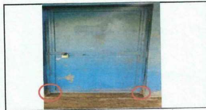
Foto 6: Se observa el deterioro de la puerta en el modulo 1 y 2
