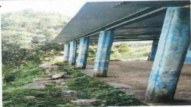
Foto 3: Se observa la necidad de colocar canales de bajadas de aguas fluviales en el modulo 1 y 2 asi mismo el murro perimetral
