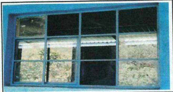
Foto 4: Se observa la necesidad de mantenimiento de la ventana en el modulo 1 y 2
