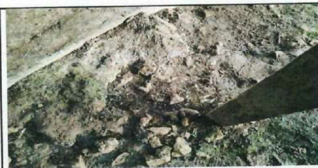
Foto 5: Se observa la necesidad de reparacion de piso de torta de concreto que une el modulo 1 y 2
